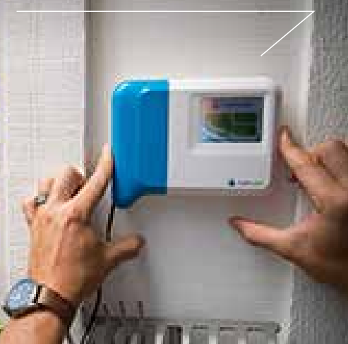
Mittels Bewässerungssteuerung kann jeder Gartenbereich individuell bewässert werden.
